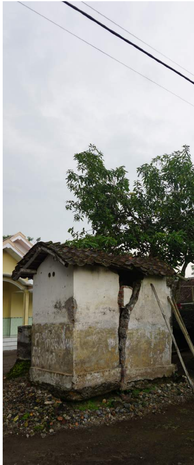
■ Gambar 62. Retakan di tembok warga
